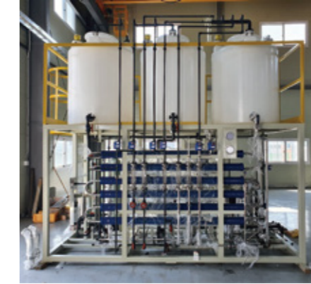
純水製造装置 (DI Water System) ／発電設備
