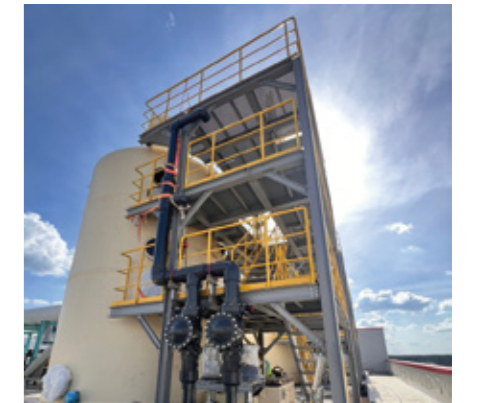
廃水処理装置
