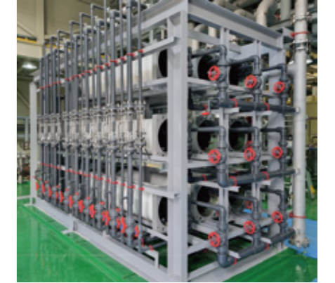
純水製造装置 (DI Water System) ／半導体プロセス用水
