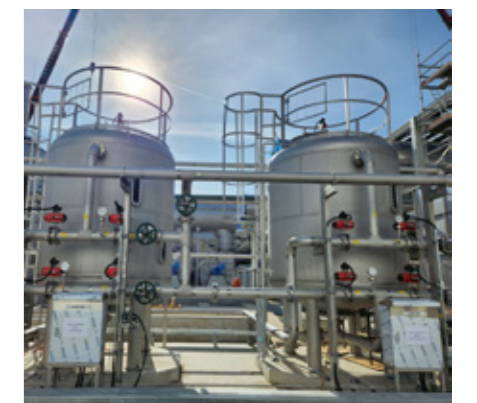
PFAS除去装置 ／活性炭システム
