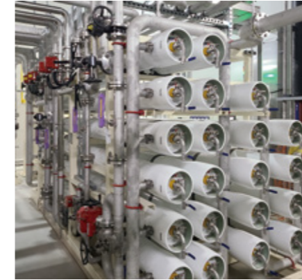
純水製造装置 (DI Water System) ／二次電池バッテリー
