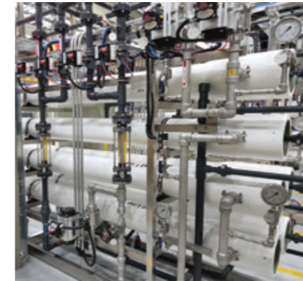
廃水再利用装置 ／リチウム再利用システム
